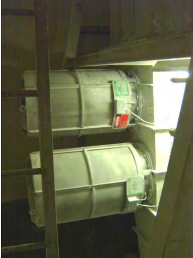
Foto 5: Vlamdovers op hamermolenonderbunker
